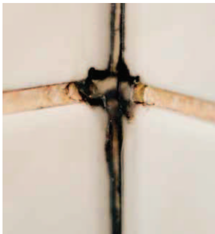
Fugemassen mellom flisene har løsnet - et dårlig tegn.
